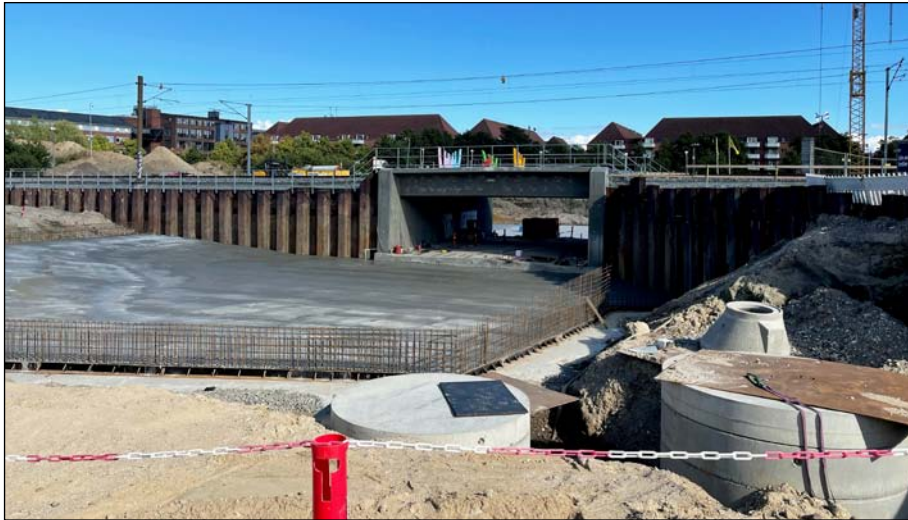
Der sker store ting ved jernbanen mellem Nørrebro og Bispebjerg. For enden af Fyrbødervej bygges den såkaldte Nordvestpassage. Planen er, at denne cykel forbindelse over tid skal fungere som en cykelrute fra Nørrebro til Bispebjerg, Østerbro, Utterslev Mose og Gladsaxe.
