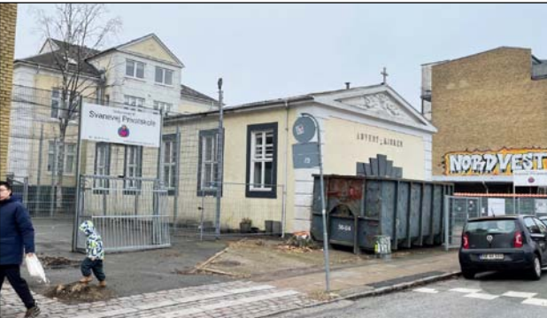
Kirken i forgrunden har sætningsskader, og skal nedrives. Skolen i baggrunden, der har stuklofter og ingen sætningsskader, er dog også besluttet at skulle nedrives.
